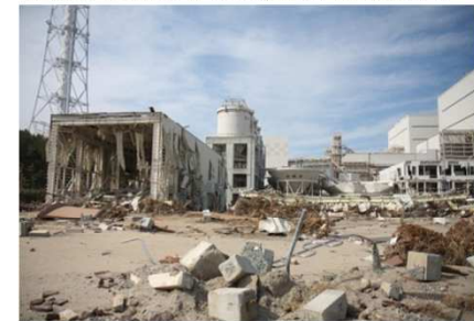
【原町火力発電所】
